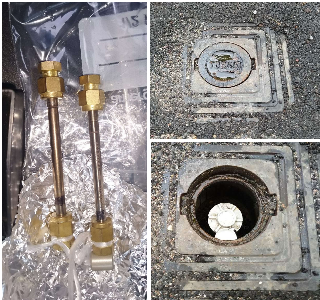
Kuva 12. Huokoskaasu- ja vertailunäytteenottimet. Huokoskaasuputki on asennettu tutkimuspisteen FCG2 kairareikään. Putken kansi on upotettu asfalttiin. Avaimella tiivistettävä korkki sijaitsee kannen alla.
